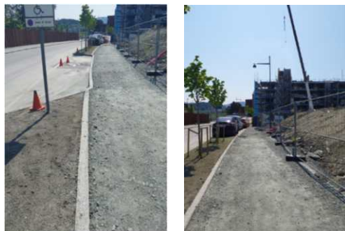
Bilder av fortau som mangler asfaltering
