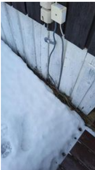
Fasader ink. kledning - [Fuktoppsug i kledning]
