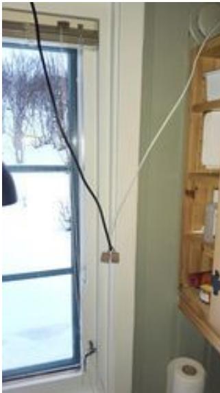
Forenklet vurdering av det elektriske anlegget - [Løse kabler kjøkken]
