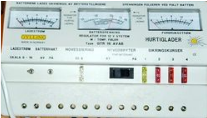
Forenklet vurdering av det elektriske anlegget - [Sikringsboks]
