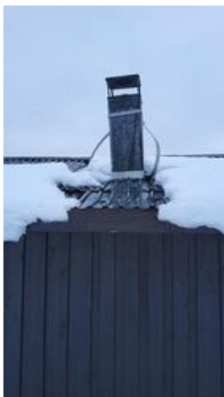
Annet - [Skader i yttertak anneks]
