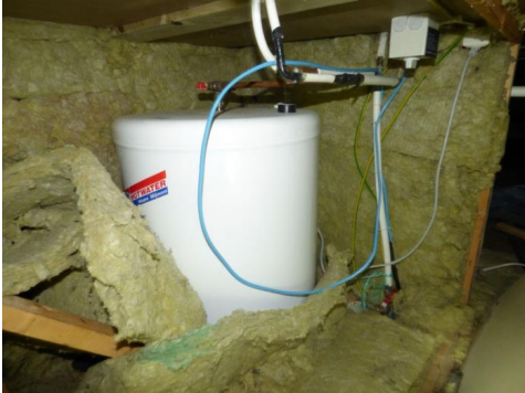
VV-bereder i krypkjeller, stoppekran nede til høyre
