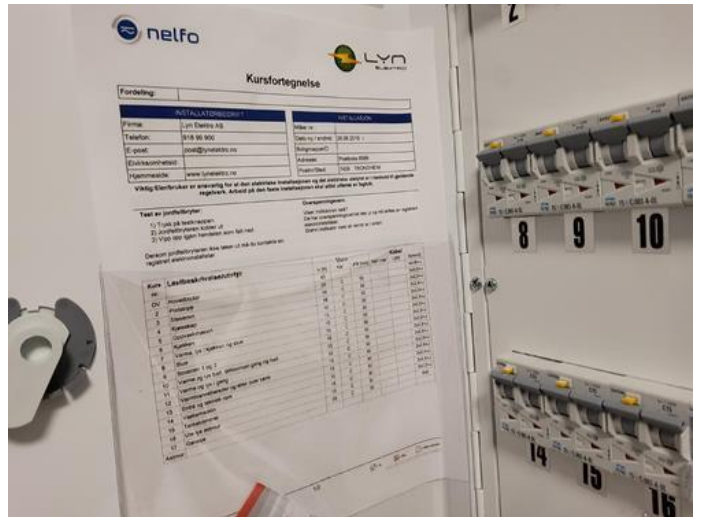
Elektrisk anlegg - [Kursfortegnelse.]
