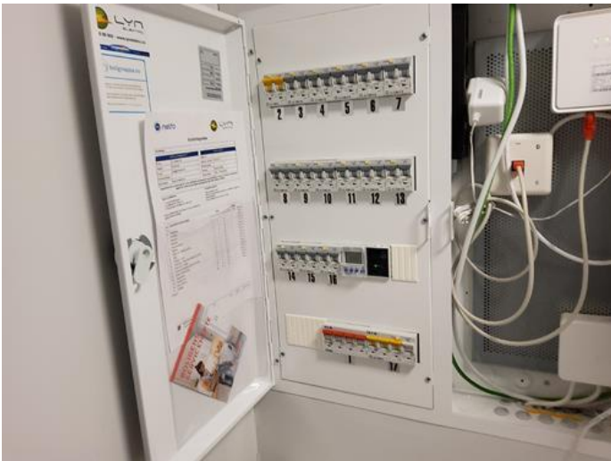
Elektrisk anlegg - [Sikringskap.]
