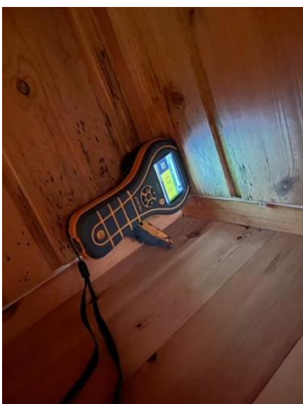
Overflater vegger - [Fuktmåling med pigg i tre på soverom.]
