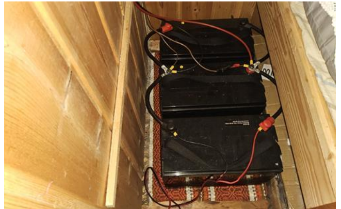
Elektrisk anlegg - [Batteri til solpanel.]
