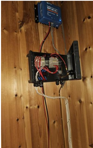
Elektrisk anlegg - [Sikringer til solpanel ]
