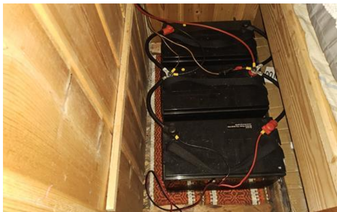
Elektrisk anlegg - [Batteri til solpanel.]
