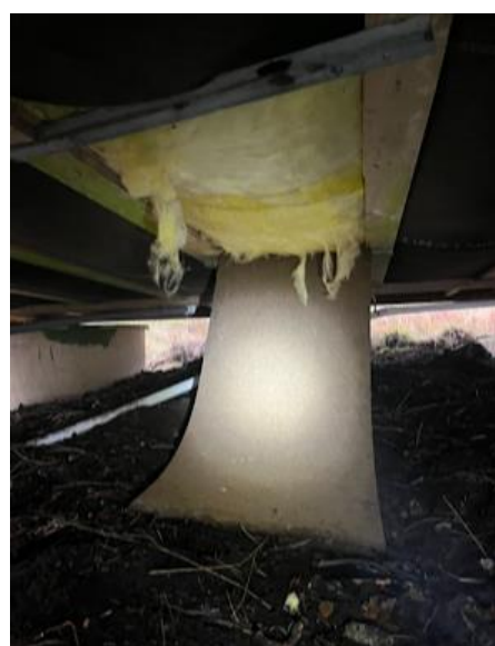
Fundamenter - [Løse stubbloftsplater. ]
