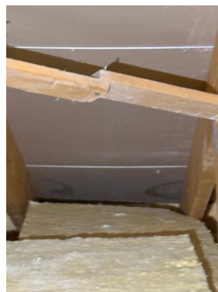
Det er registrert noen fuktskjolder på gipsplater i taket. Om fuktskjolder er fra byggeperioden, eller oppstått i senere tid, er ukjent. De bør derfor overvåkes jevnlig etter forandringer.
