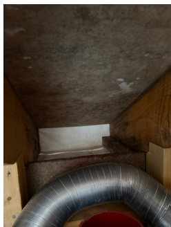
Symptomer på kondensering i undertaket i utebode.
