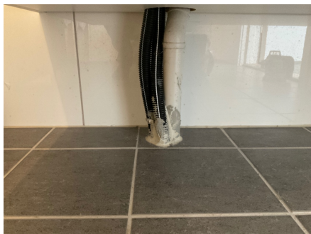
Ikke tilfredsstillende rørgjennomføring.
