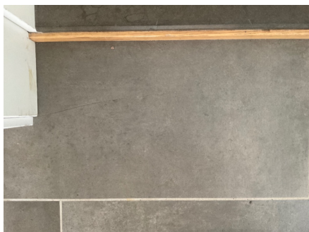
Sprukket flis i entré.
