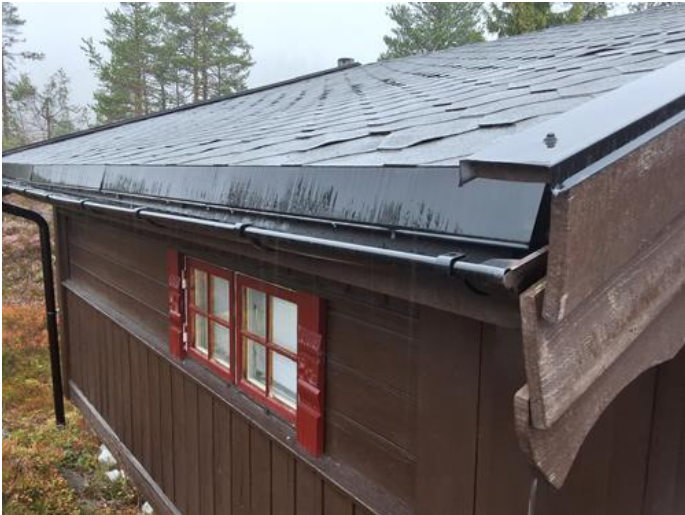
Utvendig - [Deformasjon av takrenne]
