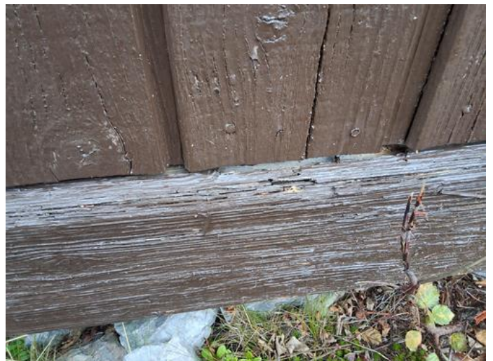
Utvendig - [Råtedannelse i bunnbord]
