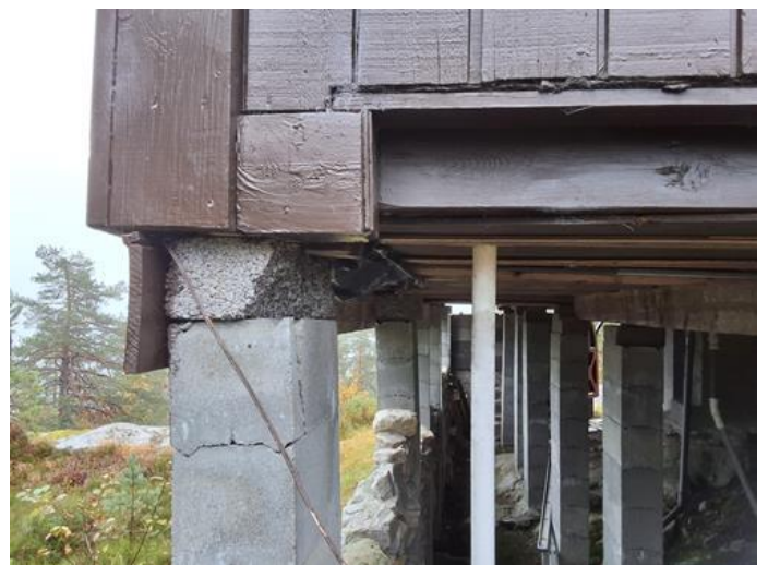
Utvendig - [Fundamenter, med noe skjevheter]
