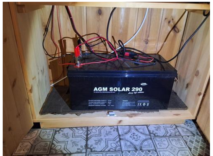
Tekniske anlegg, VVS anlegg (Sjekkpunkter utover det som er inkludert i andre rom) - [12 v anlegg 1]
