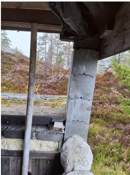
Utvendig - [Skjeve fundamenter]
