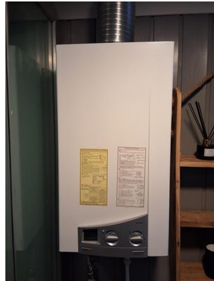
Tekniske anlegg, VVS anlegg (Sjekkpunkter utover det som er inkludert i andre rom) - [VVB på gass]
