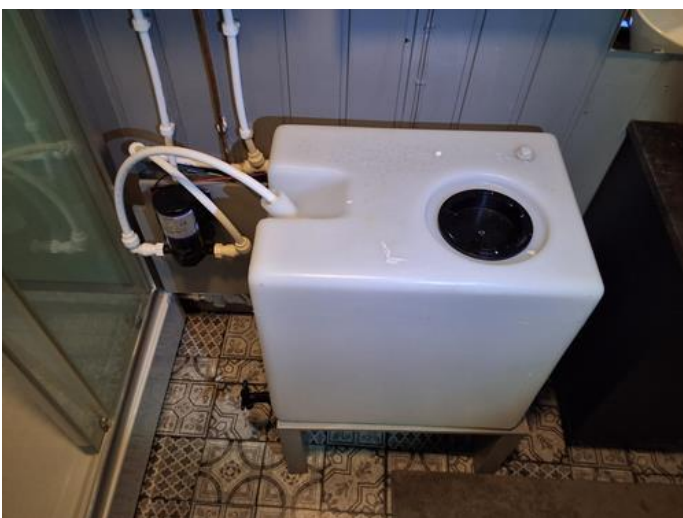
Innvendig - [Vanntank på badet]
