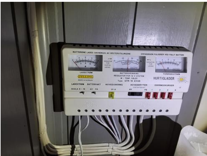
Tekniske anlegg, VVS anlegg (Sjekkpunkter utover det som er inkludert i andre rom) - [12 v anlegg 2]
