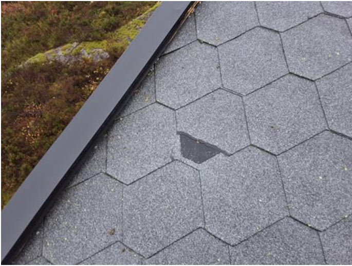
Utvendig - [Skadet del av shingel]
