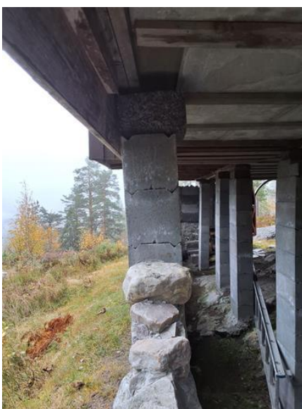
Utvendig - [Skjeve fundamenter]
