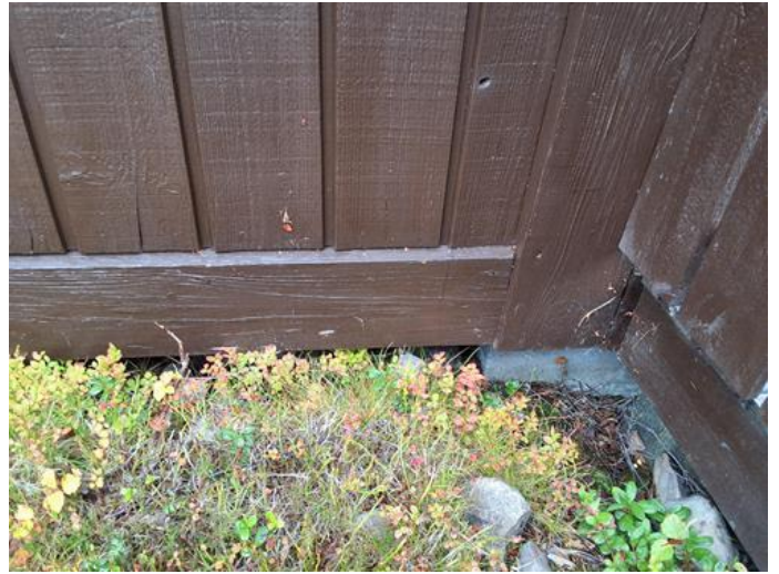
Utvendig - [Liten klaring til terreng mot sørvest]
