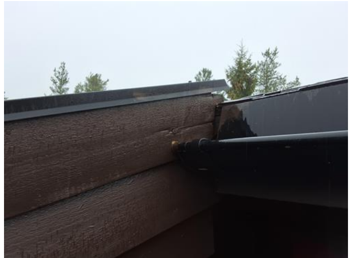
Utvendig - [Råtedannelse på øvre del av vindskie her]
