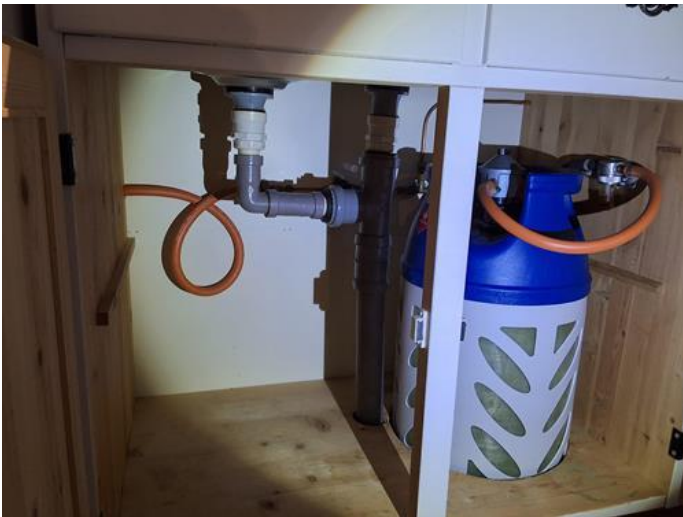
Kjøkkenen - [Røropplegg og gassflaske i kjøkkenbenk]
