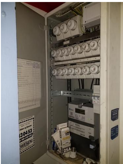
Elektrisk anlegg - [Sikringskap ]
