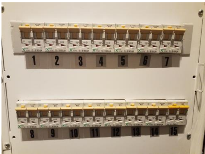
Elektrisk anlegg - [Sikringsskap. ]
