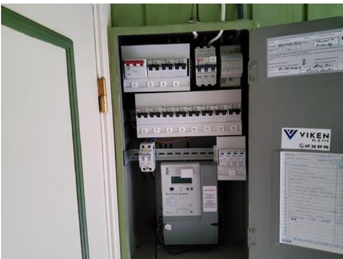
Elektrisk anlegg - [Sikringskap.]
