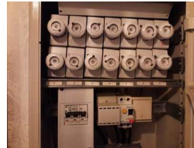
Elektrisk anlegg - [Sikringskap. ]
