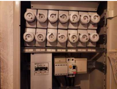
Elektrisk anlegg - [Sikringsskap. ]
