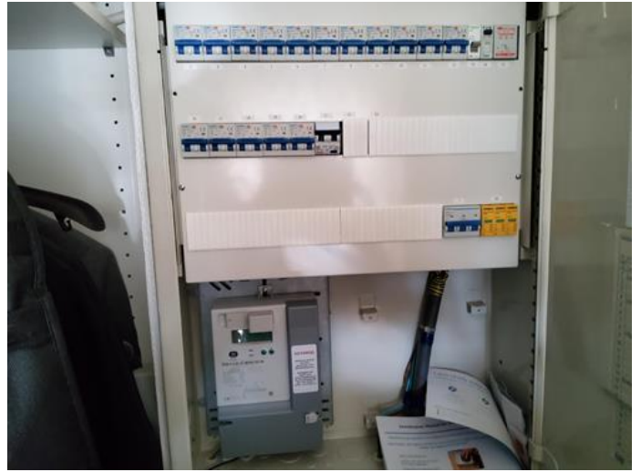
Elektrisk anlegg - [Sikringskap. ]
