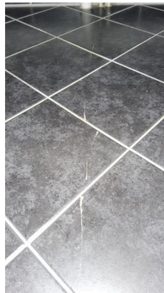
Overflater gulv - [Sprikker i flis på bad]
