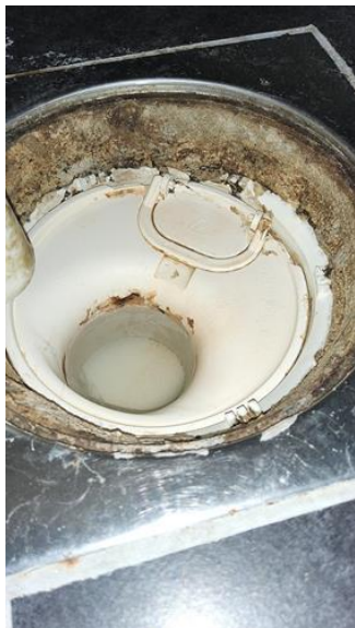
Avløpsrør (ink. sluk) - [Sluk bad hoveddel]
