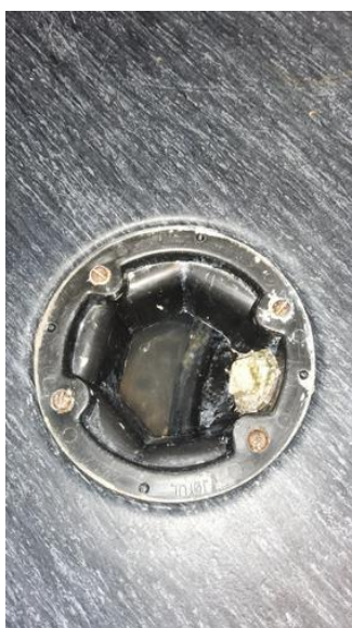
Avløpsrør (ink. sluk) - [Sluk vaskerom]
