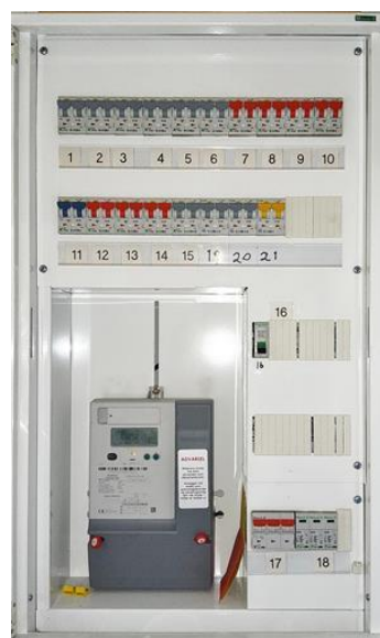
Forenklet vurdering av det elektriske anlegget - [Sikringskap]
