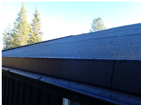
Manglende forskriftsmessig takstige for feier.
