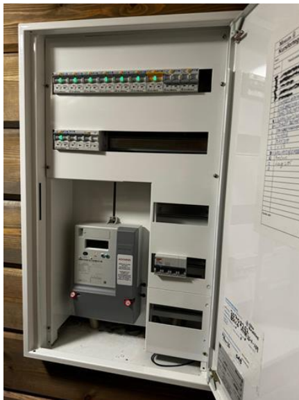
Forenklet vurdering av det elektriske anlegget - [Sikringskap]
