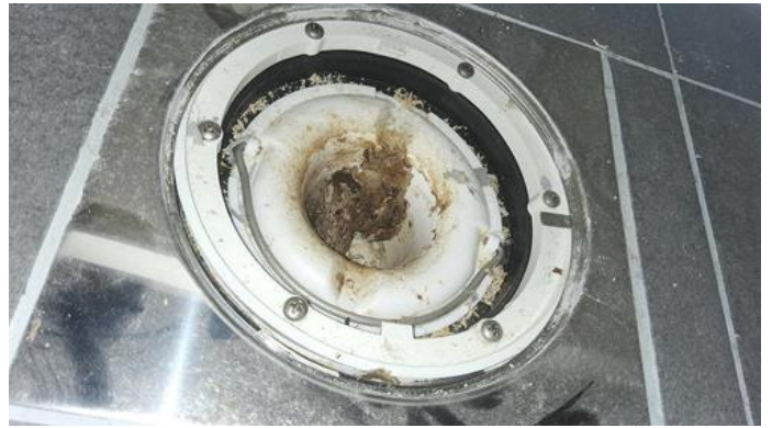
Avløpsrør (ink. sluk) - [Sluk bad]
