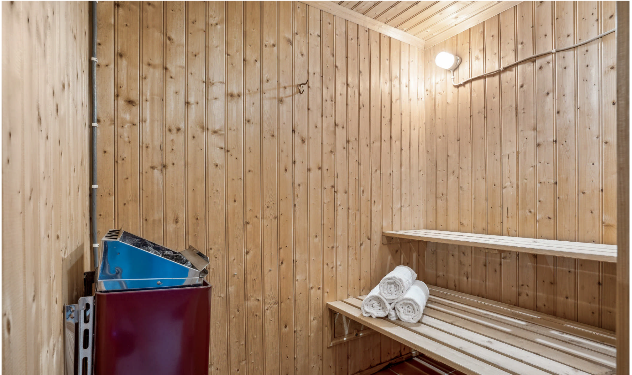
Badstue i kjeller, ikke tilstrekkelig rømning fra kjeller. ikke godkjent.
