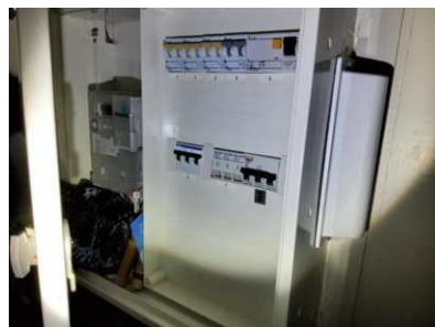
Elektrisk anlegg - [Sikringsskap.]
