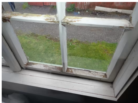
Vinduer er med slitte overflater.
