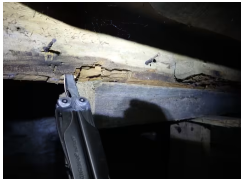
Synlige råteskader i bærende konstruksjon i krypkjeller/jordkjeller.
