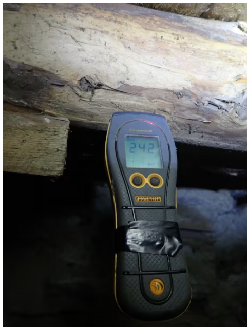
Høye fuktverdier samt råte i jordkjeller under stue.
