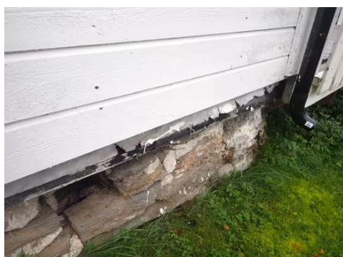
Liggende kledning mot hage, vindsperre trekker fukt.
