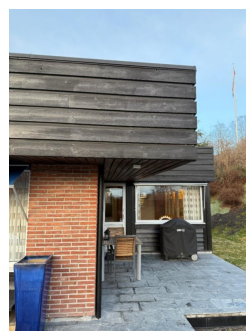
Ujevnheter under utkraget takkonstruksjon.
