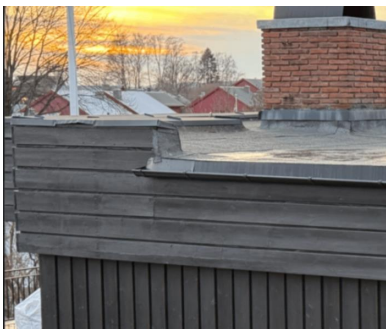
Avvik på detaljer ved takrennen.
