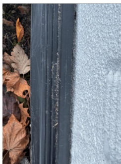
Mangler tetting mot grunnmuren.
