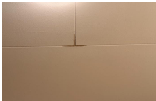
Symptomer på fukt.
