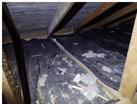
Manglende lufting ved raft
