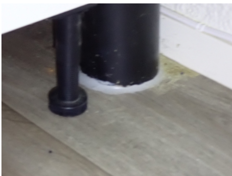
Rør gjennom gulv
