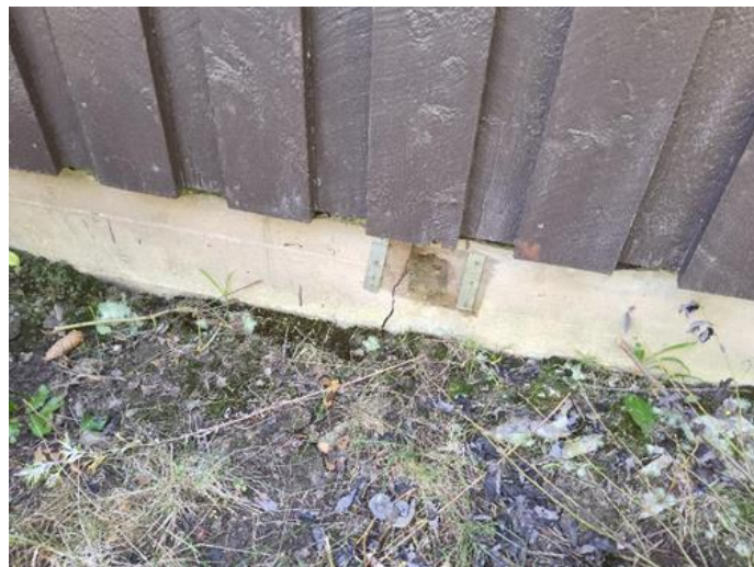
Utvendig - [Sprekk i grunnmur]
