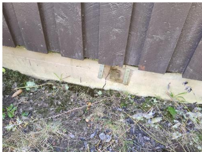
Utvendig - [Sprekk i grunnmur]
