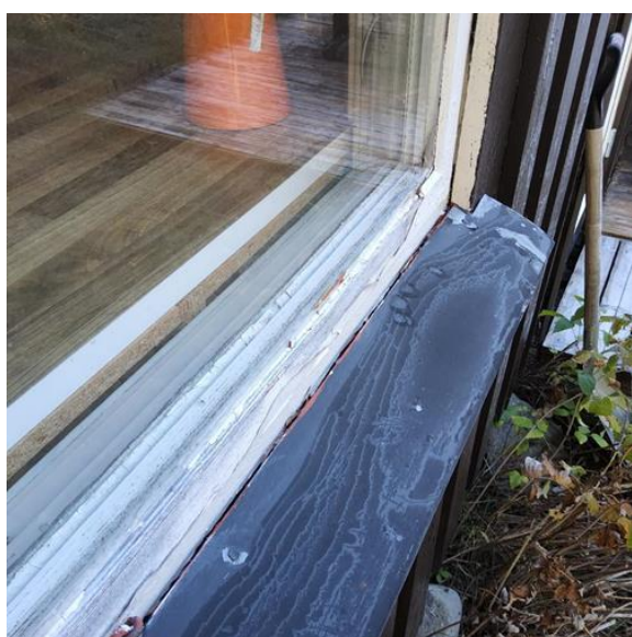
Utvendig - [Eksempel på slitasjer og glipe ved vannbrett kjøkkenvindu]
