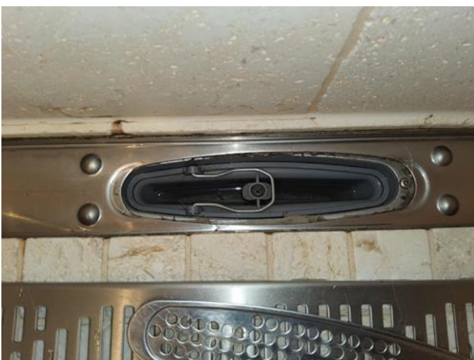
Avløpsrør (ink. sluk) - [Sluk på bad 1.etasje. ]
