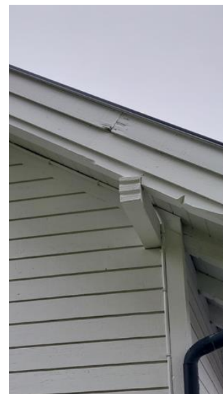
Fasader ink. kledning - [Råteskade i vindskie mot nord. ]
