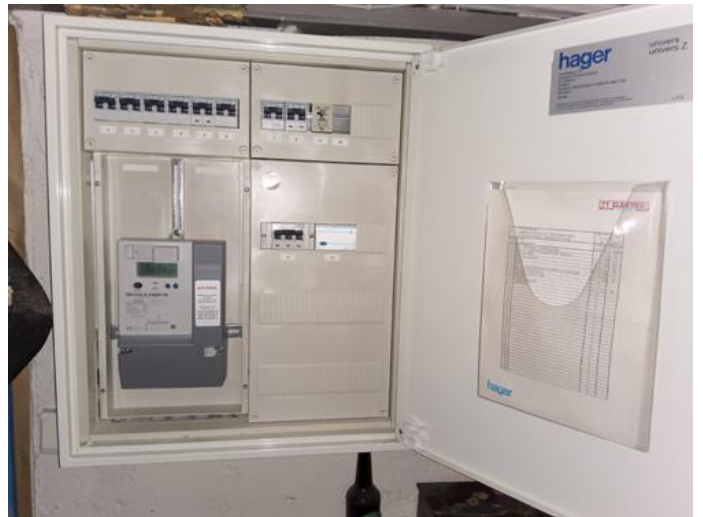
Elektrisk anlegg - [Sikringskap i kjeller. ]
