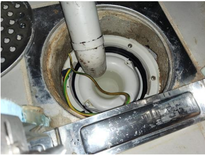
Avløpsrør (ink. sluk) - [Sluk på bad 2.etasje. ]
