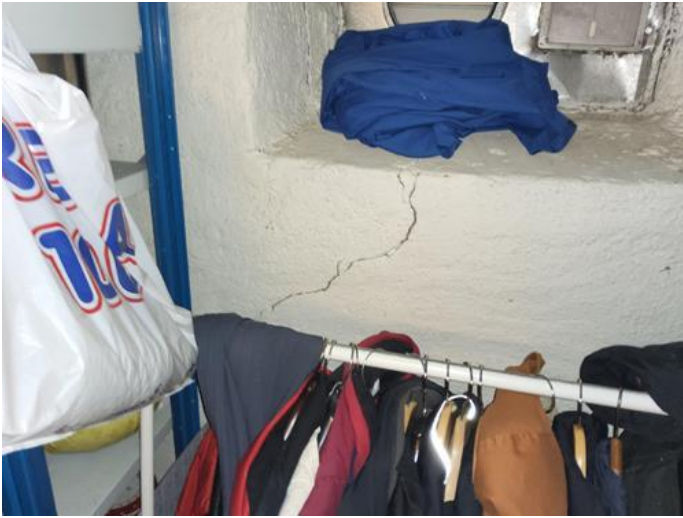
Overflater vegger - [Sprekke i vegg i kjellerrom. ]
