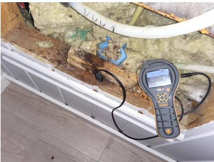
Annet - [Fuktmåling i trevirke under fordelerskap for rør-i-rør. ]
