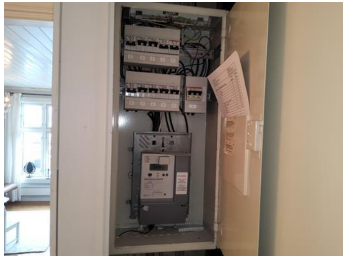
Elektrisk anlegg - [Sikringskap 2.etasje. ]
