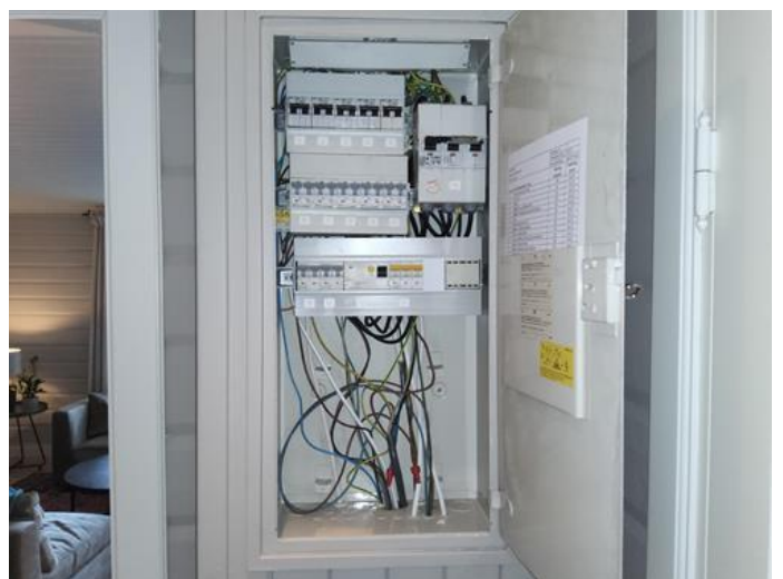
Elektrisk anlegg - [Sikringskap 1.etasje. ]
