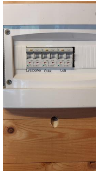
Elektrisk anlegg - [Sikringskap i garasje. ]
