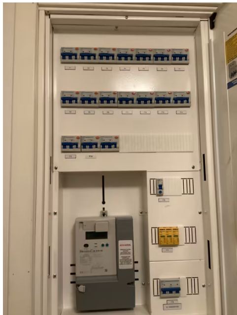
Sikringskap med automatsikringer plassert i vegg på vaskerom.
