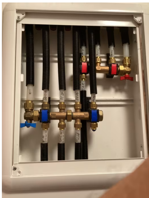
Rørfordelerskap plassert i vaskerom.
