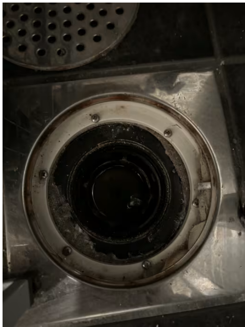
Baderomssluk plassert lett tilgjengelig på gulv i vaskerom.
