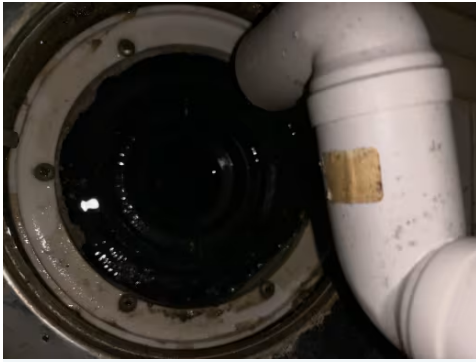
Baderomssluk plassert i gulv under innmurt badekar.
