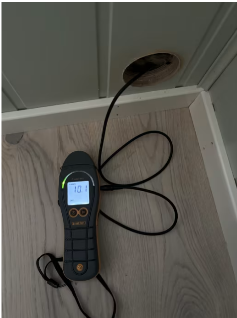
Hulltaking med fuktmåling uten avvik, målt fra tilliggende soverom.
