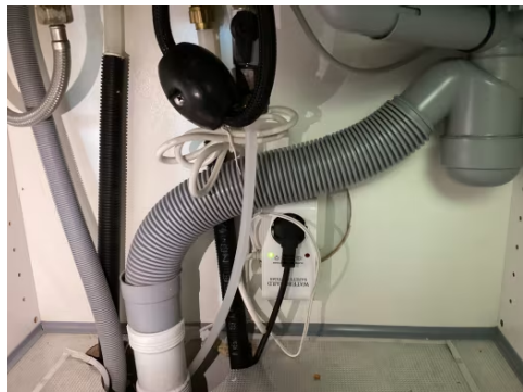
Avløpsrør i underskap vask på kjøkkenet.
