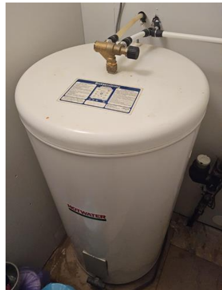
Varmtvannsbereder (Sjekkpunkter utover det som er inkludert i andre rom) - [Varmtvannsbereder]
