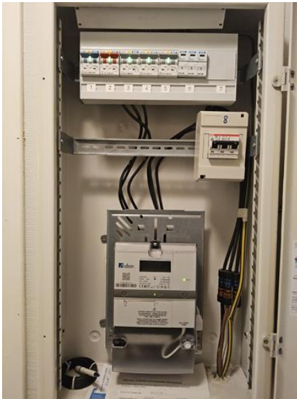
Elektrisk anlegg - [Sikringskap]
