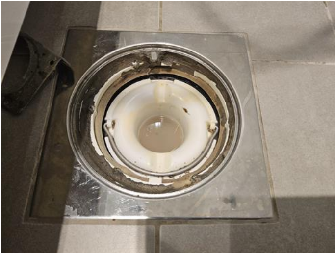
Avløpsrør (ink. sluk) - [Sluk baderom]
