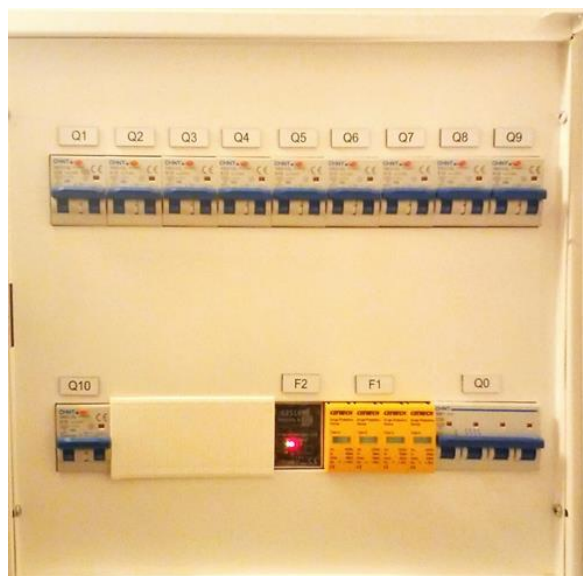
Forenklet vurdering av det elektriske anlegget - [Sikringsskap]
