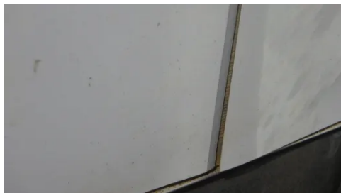
Løst tettesjikt på våtromsplate i dusjnise.
