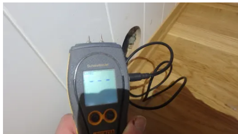
Fuktmåling i tilstøtende vegg fra bod.
