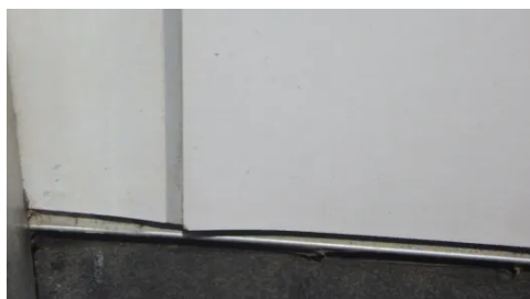
Løst tettesjikt på våtromsplate i dusjnise.
