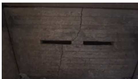
Sprekk i ildfastplate i ovn.
