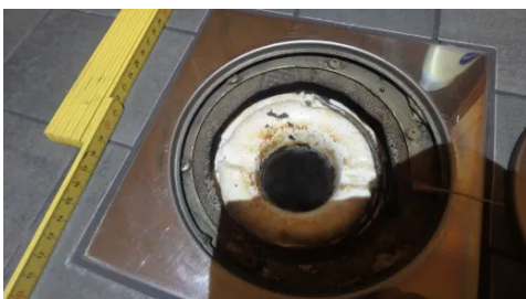
Sluk med synlig membran.
