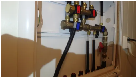
Rørskap med stoppekran plassert på bod.
