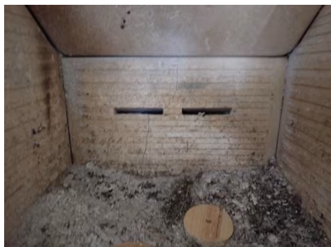
Sprekk i ildfaststein.
