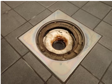
Slukløsning med synlig slukmansjett og membran under klemring i sluket.
