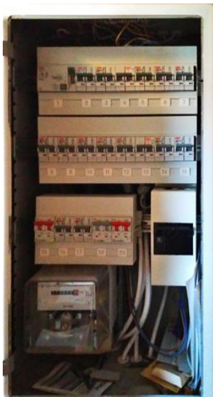
Forenklet vurdering av det elektriske anlegget - [Sikringsskap]
