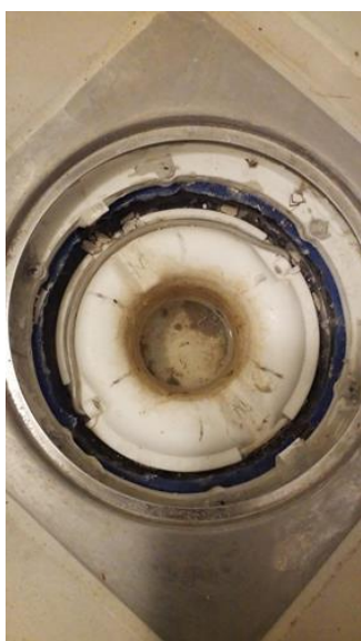
Avløpsrør (ink. sluk) - [Sluk bad kjeller]
