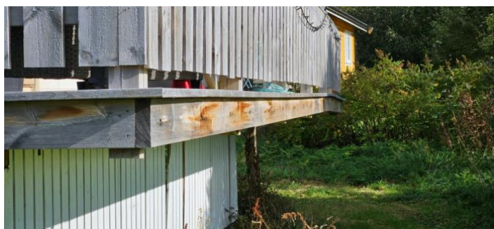
Skjevhet i balkongdekket
