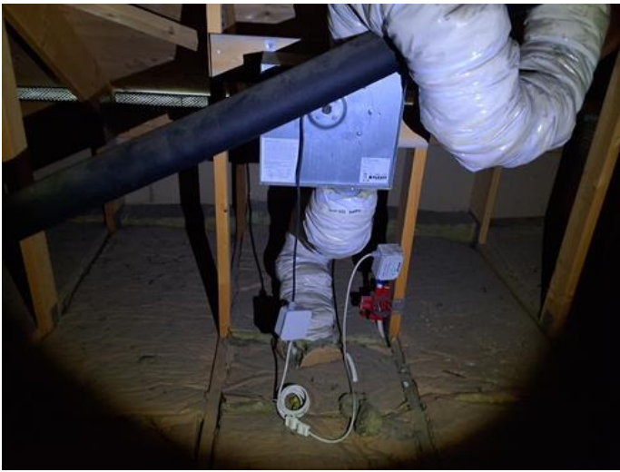
Loft - uinnredet / råloft - [Avtrekksvifte tilhørende bad på loftet.]
