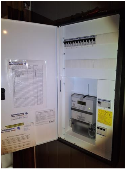
Elektrisk anlegg - [Sikringskap]
