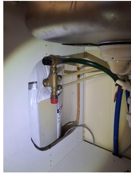
Varmtvannsbereider (Sjekkpunkter utover det som er inkludert i andre rom) - [VVB i kjøkkenbenk]
