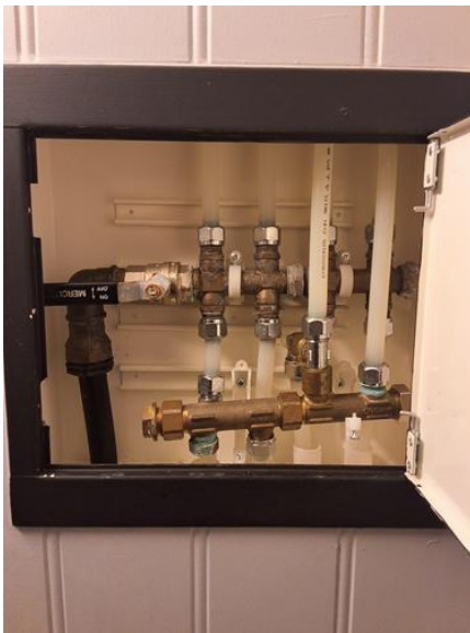
Hovedstoppekran - [Hovedstoppekran og koblingskap for vannrør]
