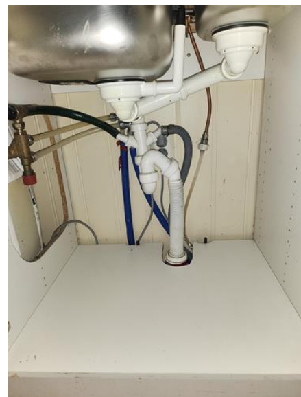
Kjøkken - [Rørapplegg i kjøkkenbenk]
