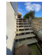
Det mangler rekkverk i trapp til kjeller.
