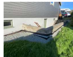
Mur rundt trappenedgang mangler rekkverk.
