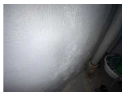
Avløpsrør i soil. Det er saltslag på vegg.
