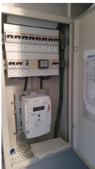
Elektrisk anlegg - [Sikringskap]
