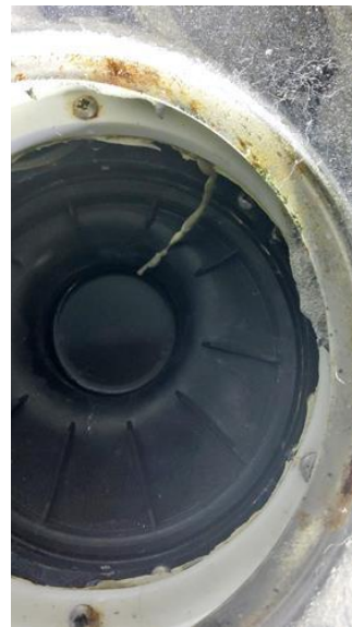
Våtrom - [sluk vaskerom]
