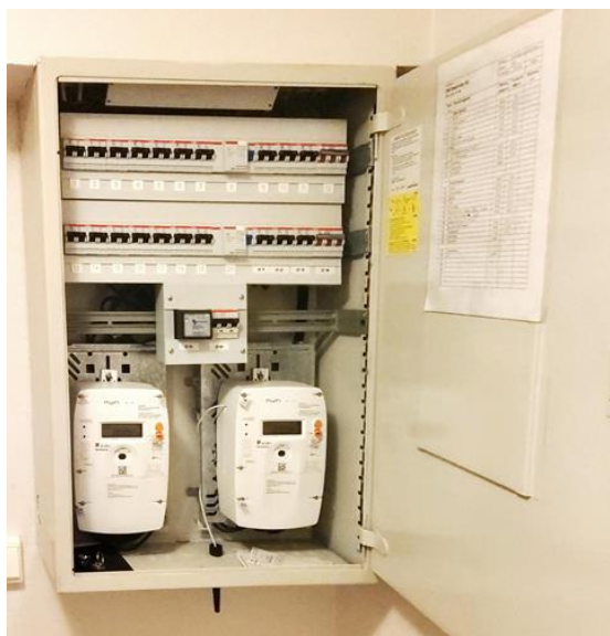
Elektrisk anlegg - [Sirkingskap]
