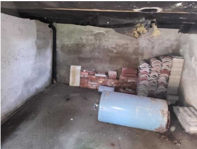
Rom under terreng (kjeller, underetasje, sokkeletasje) - [Eksempel på fuktproblematikk og skader i kjeller i tilleggsdel ]
