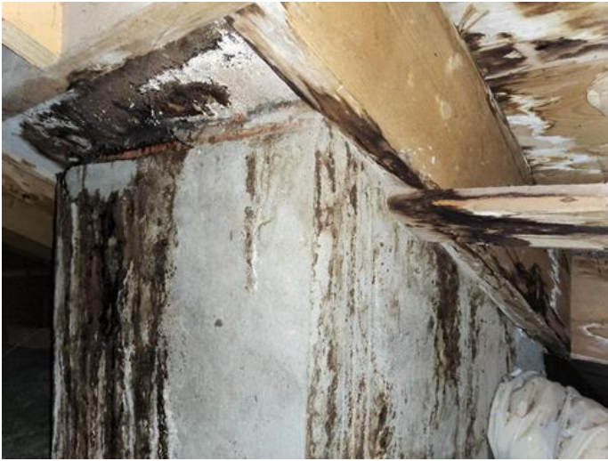
Loft - uinnredet / råloft - [Eksempel på fukt og sotskjolder på loft hoveddel]
