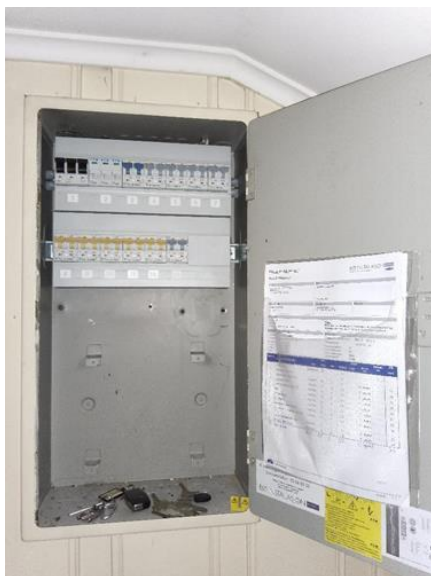
Elektrisk anlegg - [Sikringskap og kursoversikt i hoveddel]
