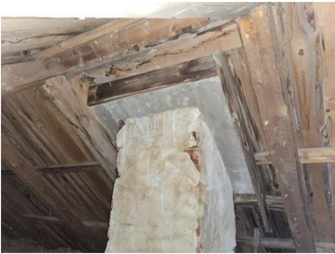
Loft - uinnredet / råloft - [Fuktskjolder og avflassing på pipe loft tilleggsdel ]
