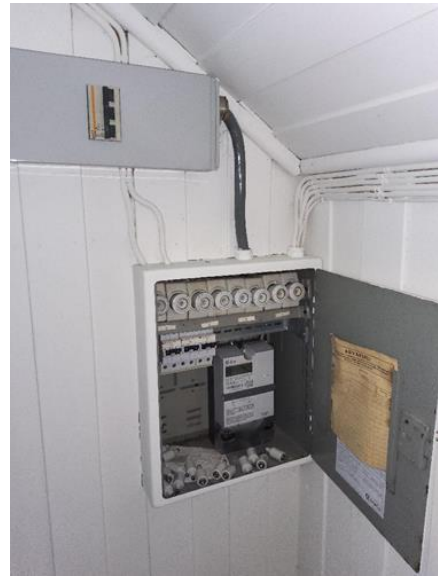
Elektrisk anlegg - [Sikringsskap og kursoversikt i tilleggsdel]
