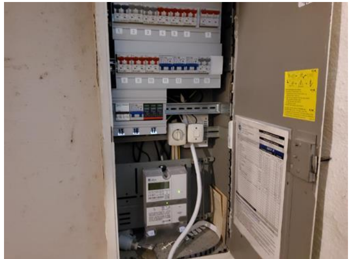
Elektrisk anlegg - [Sikringskap. ]
