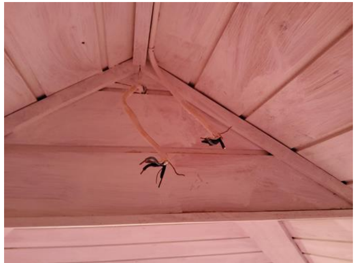
Elektrisk anlegg - [Løse ledninger i loftsetasje.]
