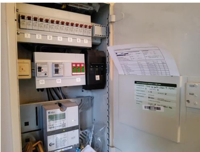
Kommentar - [Sikringskap i underetasje.]
