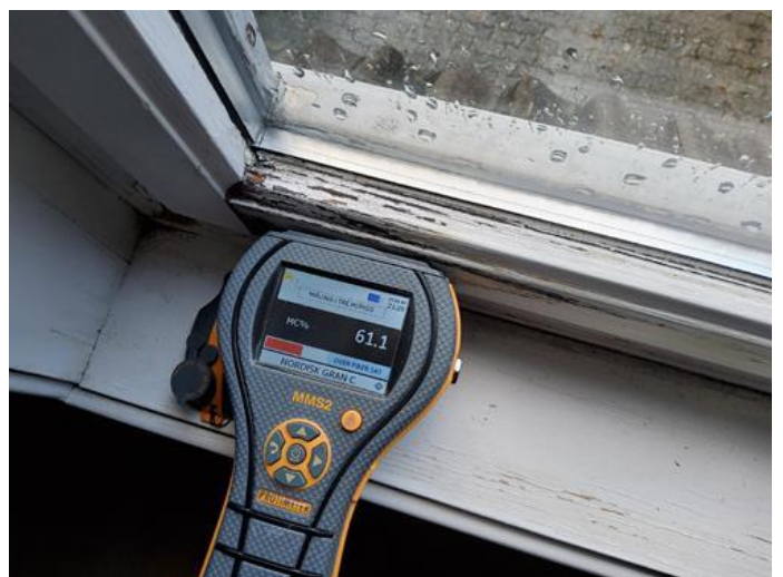
Kommentar - [Fuktmåling vindu i loft over garasje.]
