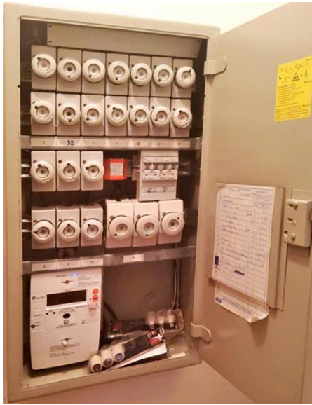
Elektrisk anlegg - [Sikringskap]
