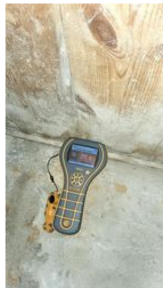
Helhetsvurdering - [Fuktmåling i kjellervegg]
