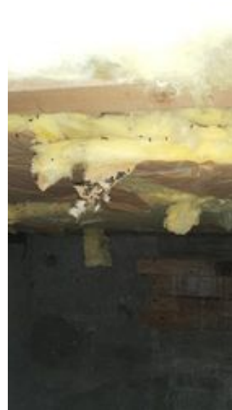
Innvendig inspeksjon - [Spor etter gnagere]
