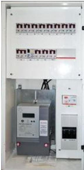
Forenklet vurdering av det elektriske anlegget - [Sikringskap]
