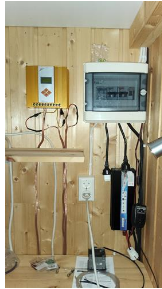
Forenklet vurdering av det elektriske anlegget - [Sikringsboks]
