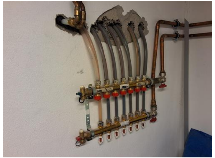
Tekniske anlegg, VVS anlegg (Sjekkpunkter utover det som er inkludert i andre rom) - [Samlestokk for vannbåren varme]
