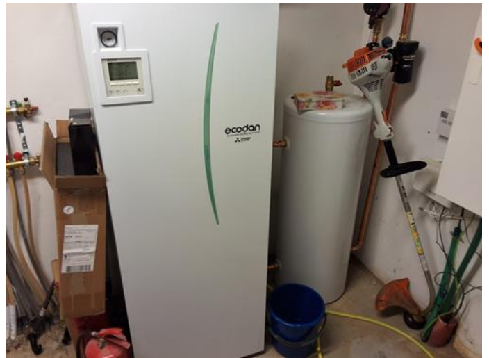
Tekniske anlegg, VVS anlegg (Sjekkpunkter utover det som er inkludert i andre rom) - [Sirkulasjonspumpe og varmtvannsbereder]
