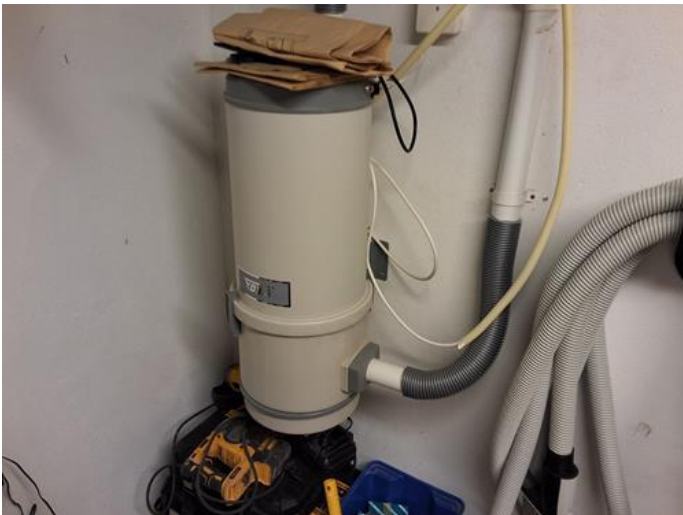
Tekniske anlegg, VVS anlegg (Sjekkpunkter utover det som er inkludert i andre rom) - [Sentralstøvsuger]
