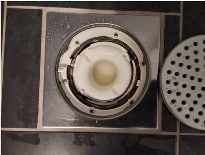
Avløpsrør (ink. sluk) - [Sluk bad u.etg]
