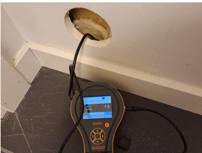
Konstruksjoner (tilfarergulv, himling og vegger). - [Fuktmåling i utlektet kjellervegg]
