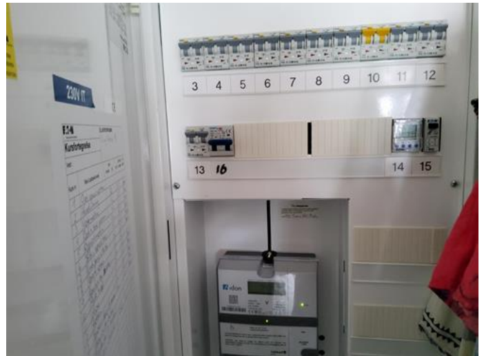
Elektrisk anlegg - [Sikringskap. ]
