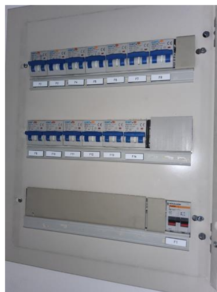
Elektrisk anlegg - [Sikringsskap.]
