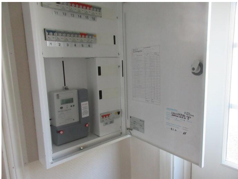
Sikringsapp med automatsikringer
