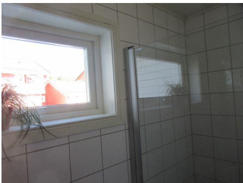
Vindu er våtsone for dusjhjørne.
