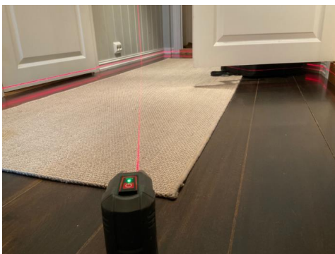
Nivellering gang, avvik ca. 10-20 mm
