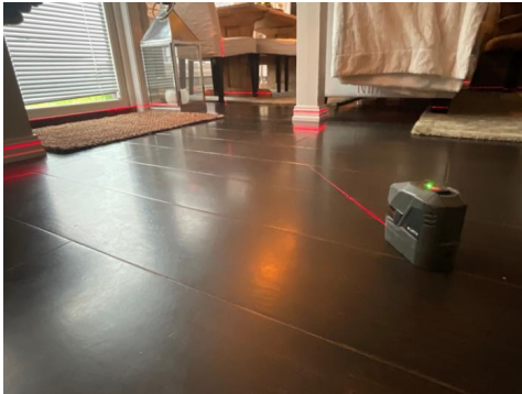
Nivellering stue/spis/kjøkken, avvik ca. 10-20 mm
