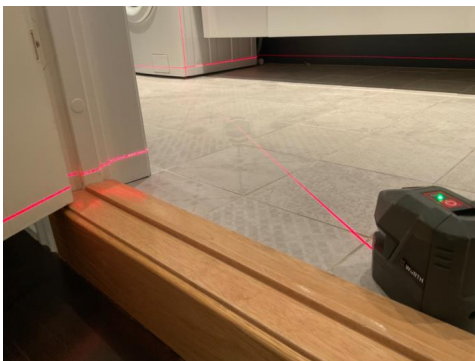
Svakt fall på hovedgulv
