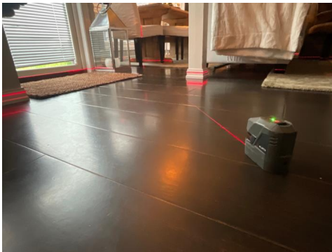
Nivellering stue/spis/kjøkken, avvik ca. 10-20 mm
