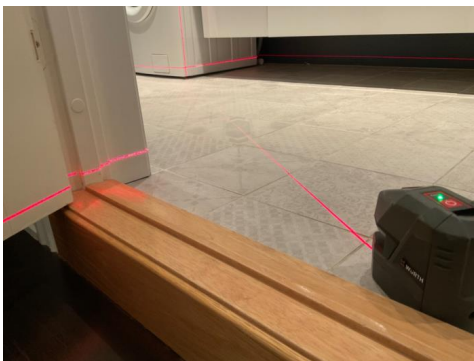
Svakt fall på hovedgulv
